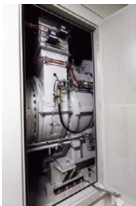
↑非常用発電機
